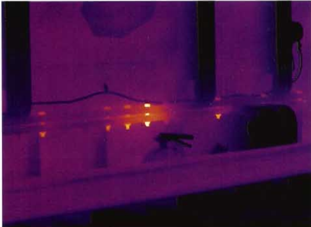
图 J.4 变压器漏磁通引起的螺栓发热
