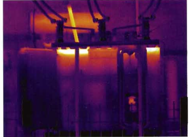
图 J.5 变压器散热风扇电动机堵转发热
