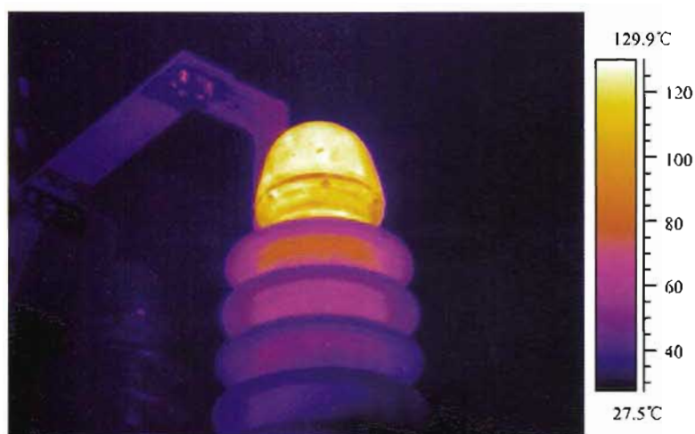
图 J. 22 电缆接头发热，连接不良
